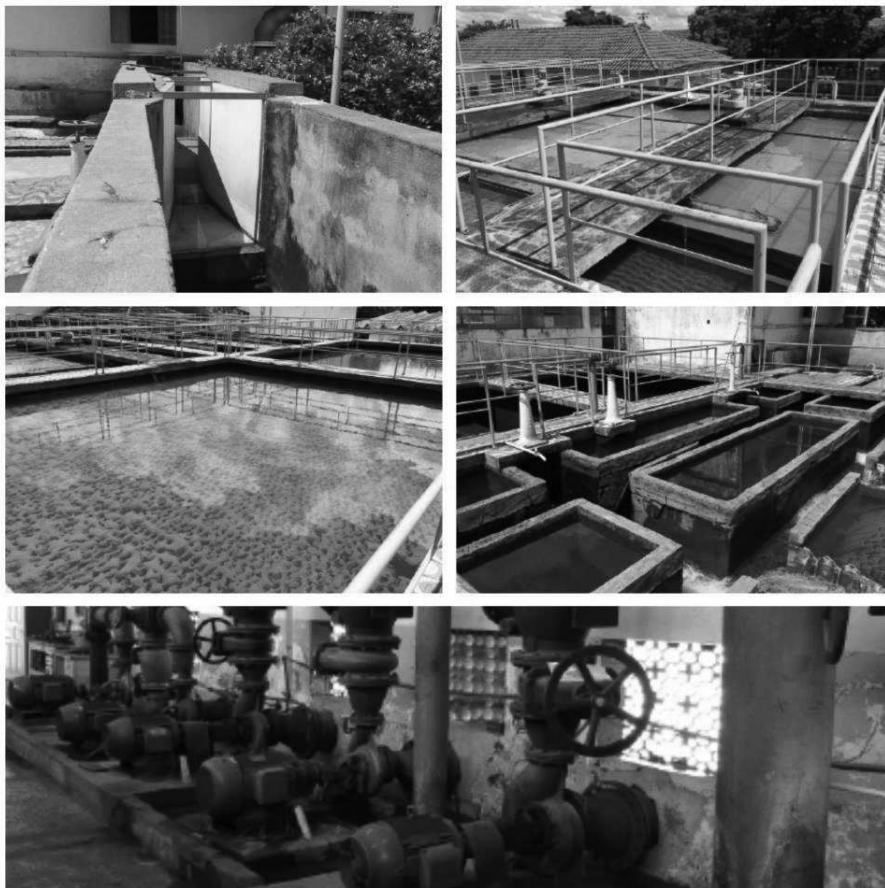
Figura 7 - IMAGENS DA ETA JULIO IGLESIAS
